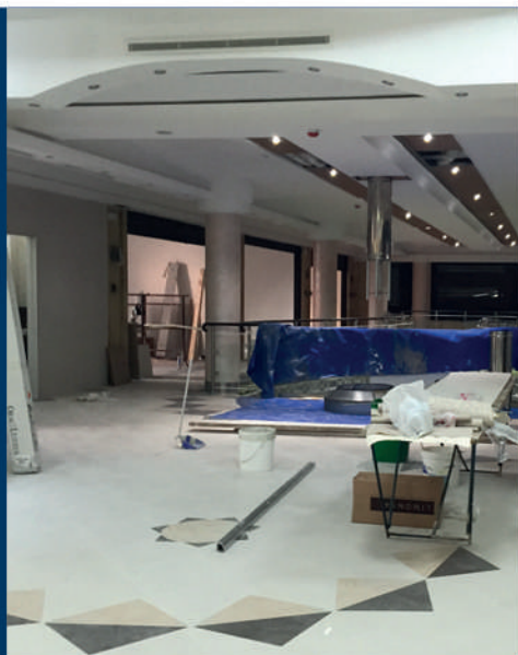
Galleria Le Vele - Castellammare di Stabia
